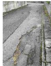
11組 大谷宅前 道路 めくり、へこみ
