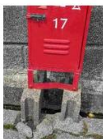
8組 定置消火器 No.17 BOX下 セメント剥がれ
