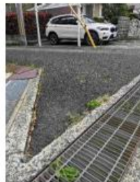
11組 三林宅前 道路 割れと沈下
